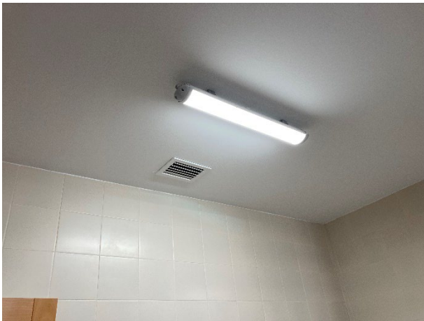
Luminaria LED en pasillo
