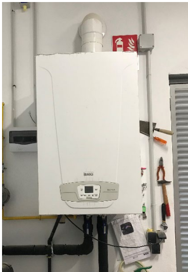
Caldera de calefacción
