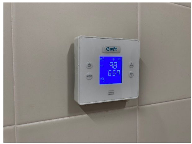
Monitorización y control
