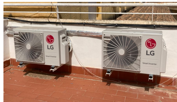
Unidades Exteriores de Refrigeración
