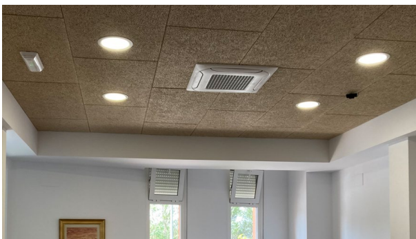
Downligh Led en planta baja
