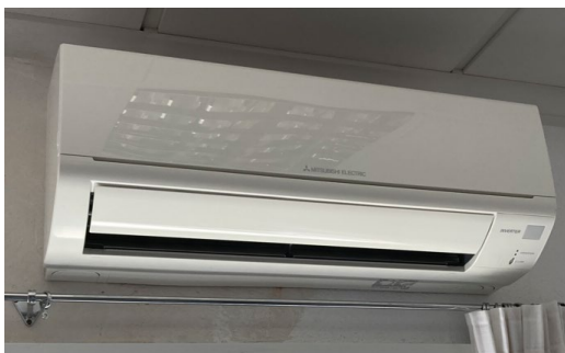
Unidades Interiores de Refrigeración
