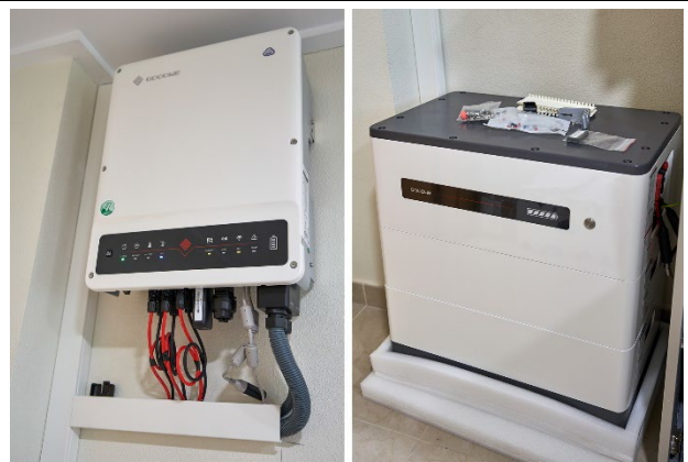
Inversor y unidad de control de potencia
