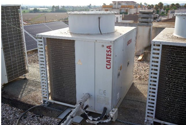
Bombas de calor en cubierta
