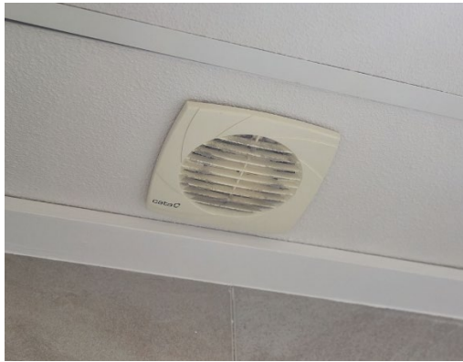
Ventilador de extracción
