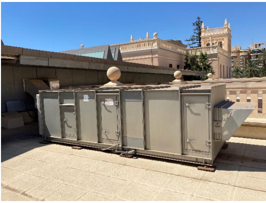
Climatizador aire exterior en cubierta
