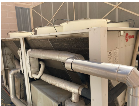
Planta enfriadora RTAD 125
