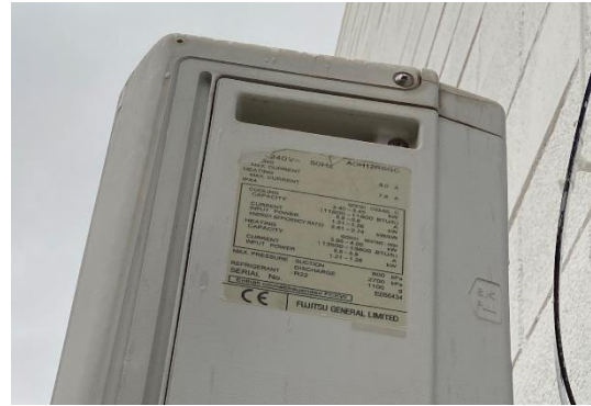
Plantas enfriadoras en cubierta
