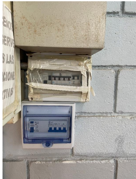
Control del sistema de extracción
