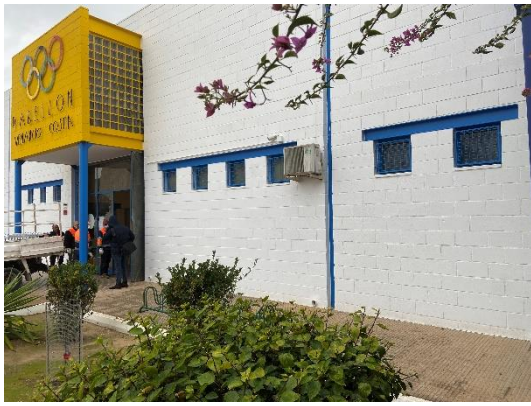
Unidad exterior del equipo Split
