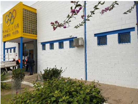
Unidad exterior del equipo Split
