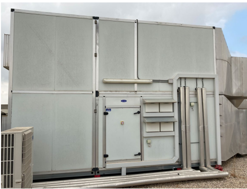
UTA de ventilación
