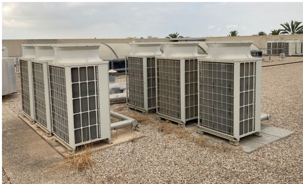
Unidades exteriores de VRV en cubierta
