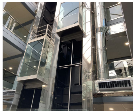
Conductos de difusión de aire primario en Hall
