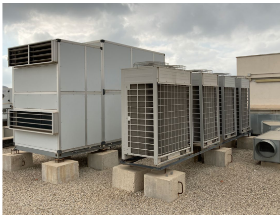
UTA de VRV en cubierta
