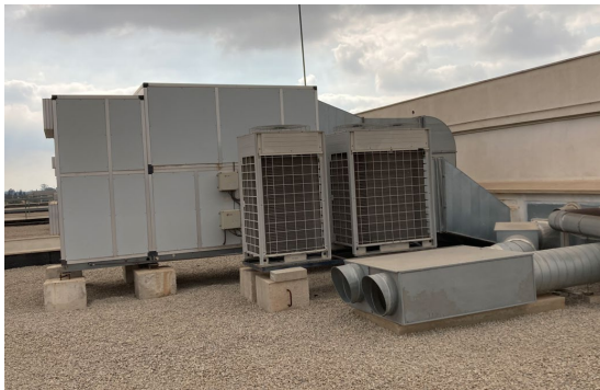
UTA de climatización y ventilación
