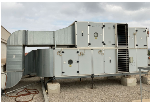
Unidad de Tratamiento de Aire
